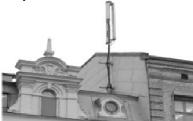
Mobilantenn på hustak
